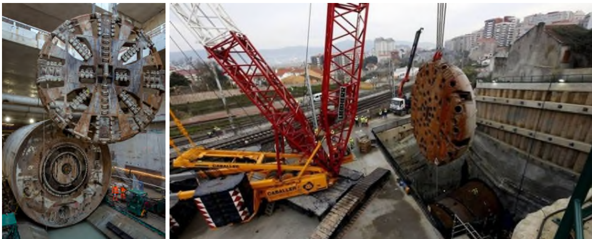
Figuur 25: Foto's van de demontage van het graafwiel van de tunnelboormachine die gebruikt werd voor de verlenging van de lijn 14 in Orly (bron: prolongementligne14-orly.fr)
