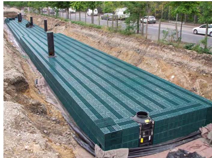
1. Bissin infiltrant Infiltratiebekken
